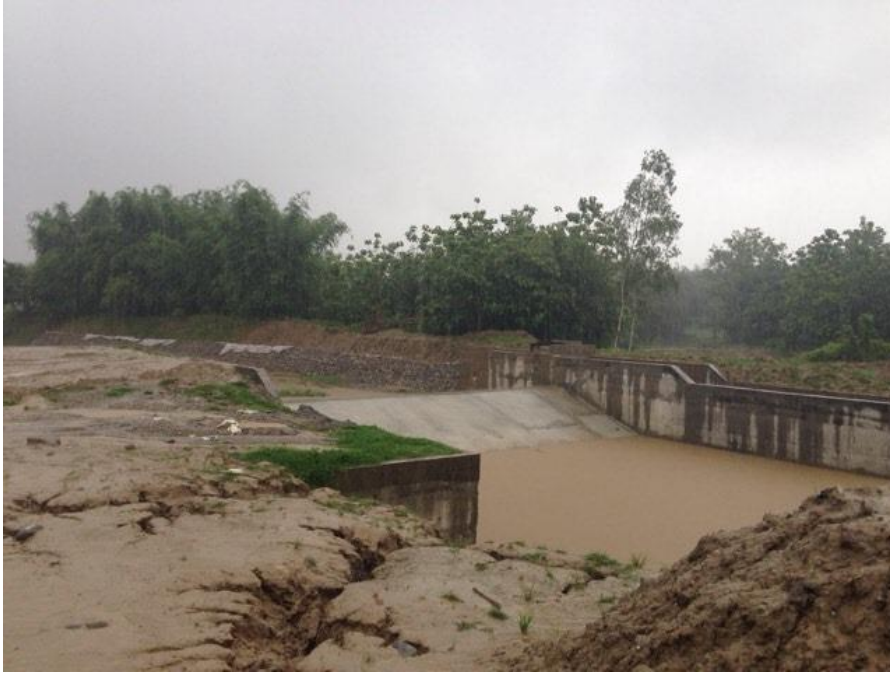
मझौला सिंचाइ अन्तर्गत तल्लो रामचंद्रे सि.यो., गौरीगंज, झापा को रामचंद्रे खोलामा निर्माणाधीन हेडवर्क्स
