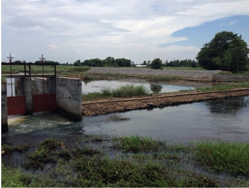
मझौला सिंचाइ अन्तर्गत सानो माइ सि.यो., टाघनडुब्बा, झापा को सनोमाइ खोलामा निर्माण सम्पन्न भएको Core Wall Type हेडवर्क्स
